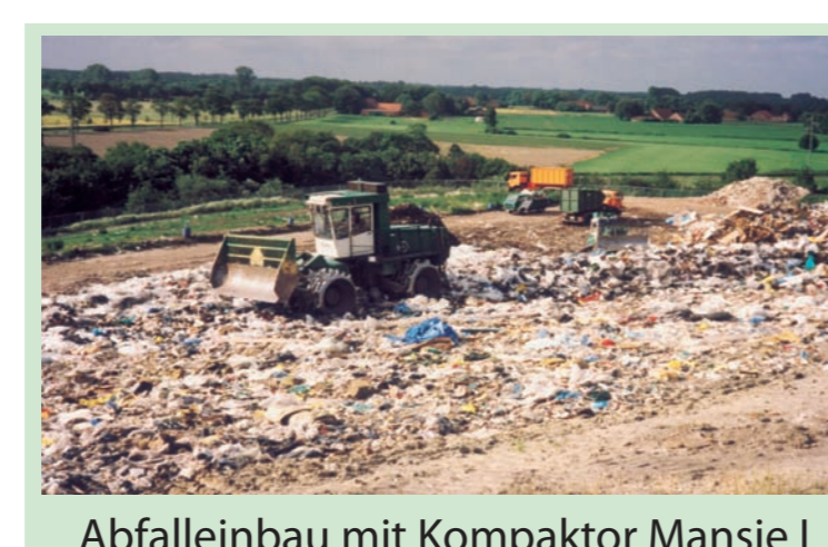
Abfalleinbau mit Kompaktor Mansie I
